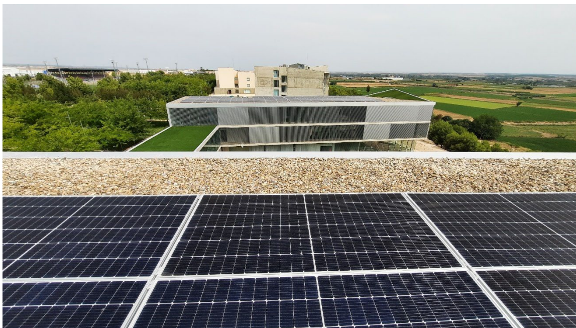
Imagen 11. Cubierta fotovoltaica. Edificio Estudiantes.
