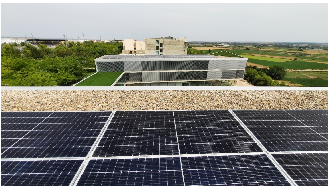
Imagen 11. Cubierta fotovoltaica. Edificio Estudiantes.
